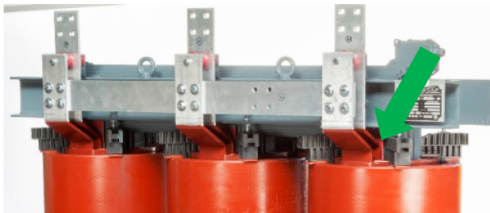
Punkt o najwyższej wartości temperatury szyn nN - znajduje się w miejscu zagięcia szyn po wyjściu z uzwojenia nN
